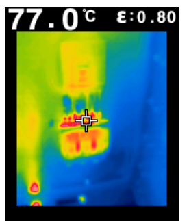
Hot-Spot-Bildung am Sicherungs-Lasttrennschalter: Kontakt und Sicherungstyp
